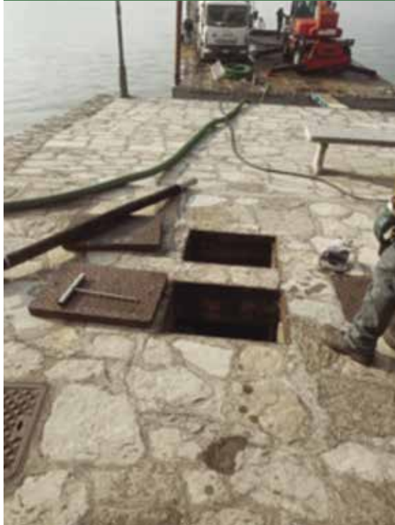
Posizionamento pompe stazione di sollevamento fognatura "Portici" e contestuale pulizia tramite autospurgo.
